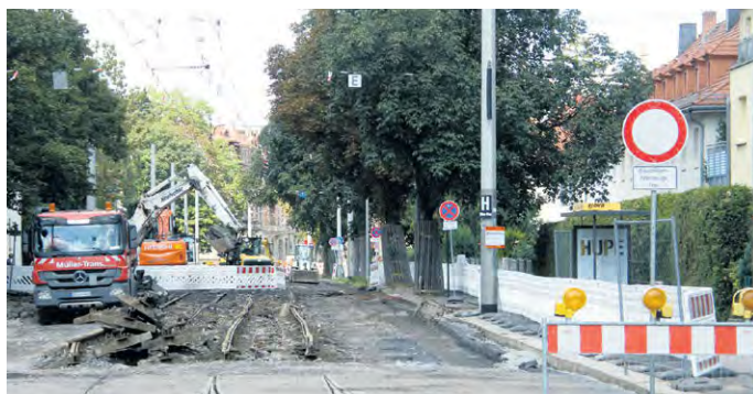
DRINGEND NOTWENDIG IST die Erneuerung der Gleise. Foto: Ziegner
