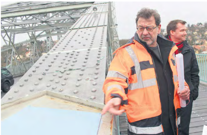
BEI EINEM VORORTTERMIN präsentierte Reinhard Koettwitz, Leiter des Straßen- und Tiefbauamtes, verschiedene Farbproben für den Schutzanstrich, den das Blaue Wunder demnächst erhalten soll. Foto: Pohl
