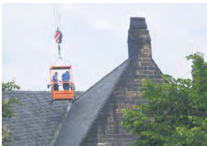
EINSATZ IN LUFTIGER Höhe: Dachdecker nehmen die Sturmschäden unter die Lupe. Foto: Ziegner
